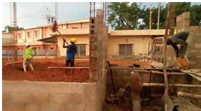
Agosto 2021 - I lavori del nuovo Pronto Soccorso all'Ospedale di Tanguiéta in Bénin
